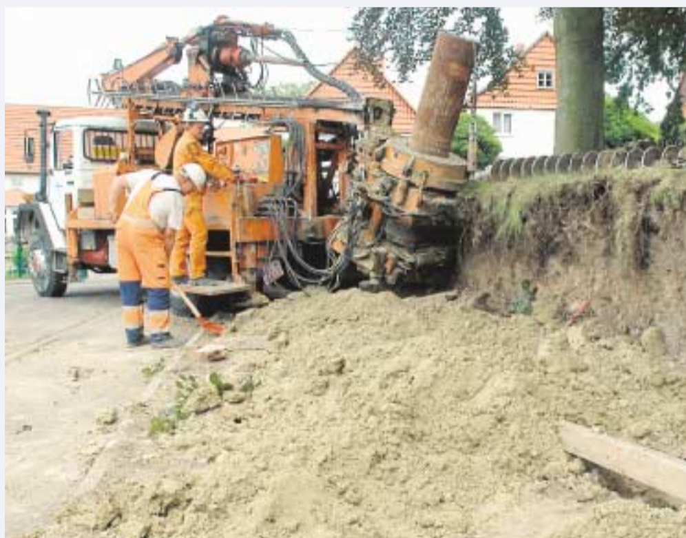
Bohrungen: Nico Warminsky und Wilfried Matthies (vorn) bereiten die Sanierung vor. Hinzmann
